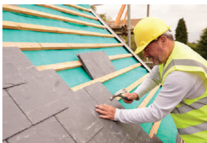
Colocación de cubiertas de pizarra o similares. Colocação de telhados de ardósia ou similares.
